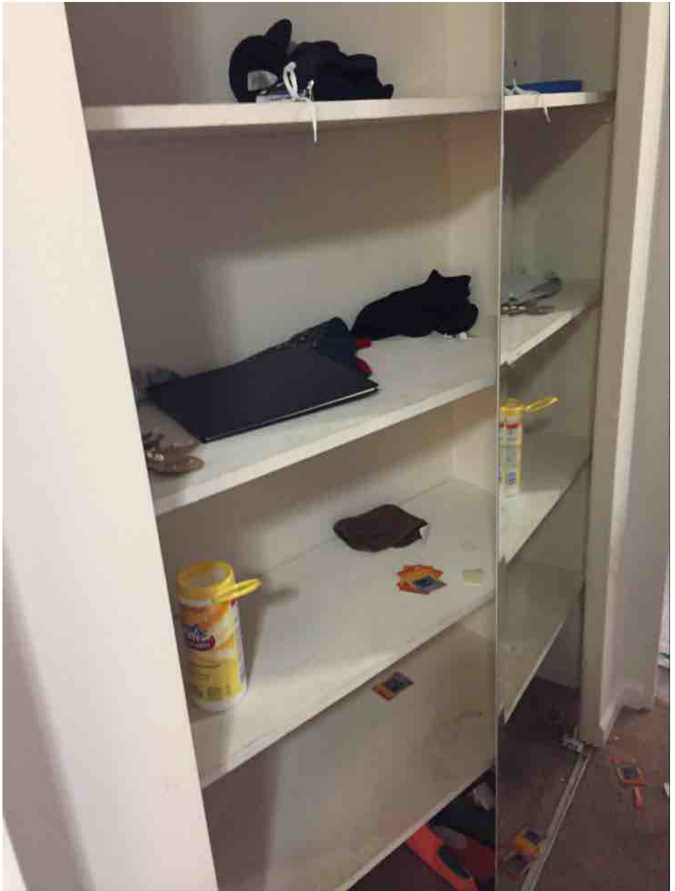
Door / Closet: Not Ok
